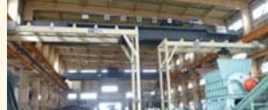
工場内 天井クレーン
